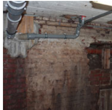
Baumängel und Bauschäden an Gebäuden - Ihr Gutachter hilft
