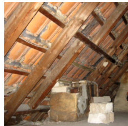
Dachfläche ohne Wärmedämmung mit erheblichen Wärmeverlusten - (c) Dipl.-Ing. Michael Schröder GmbH - Mülheim an der Ruhr
